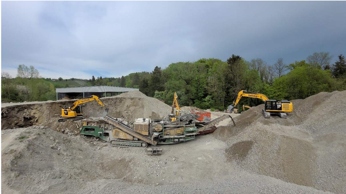
Bestehende Anlage der Batrag Tiefbau AG östlich Illhart, Wigoltingen
